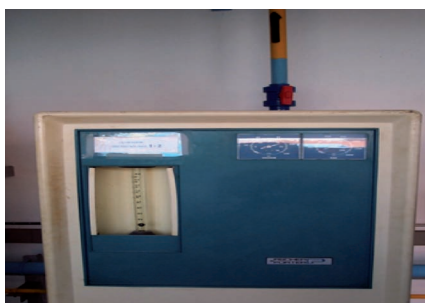
Figura 42 - Dosificador de cloro a vacío de la ETAP de Palencia.
