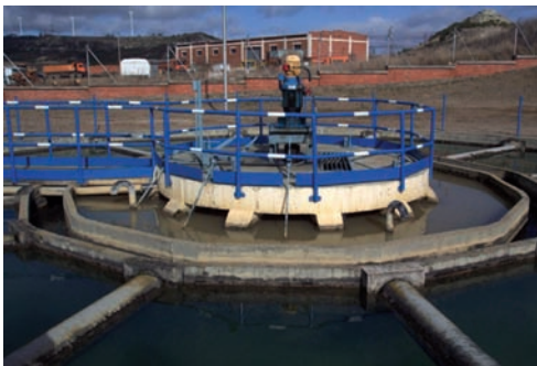
Figura 29 - Decantador de la ETAP de Palencia.
