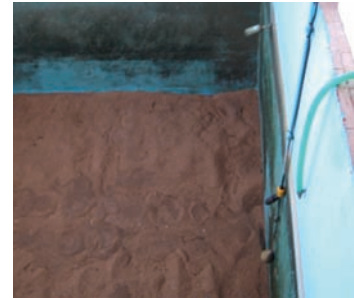
Figura 30 - Filtro de arena. ETAP de Zamora.
