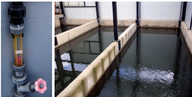
Figura 26 - Dosificador de floculante. ETAP de Ávila (izquierda). Floculadores de la ETAP de León (derecha).
