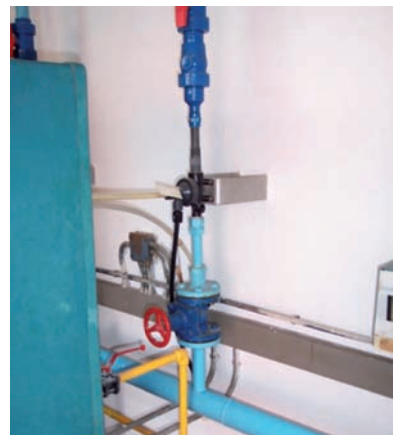
Figura 40 - Dosificador de cloro gaseoso. ETAP Palencia.
