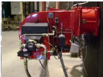
Control digital en calderas
