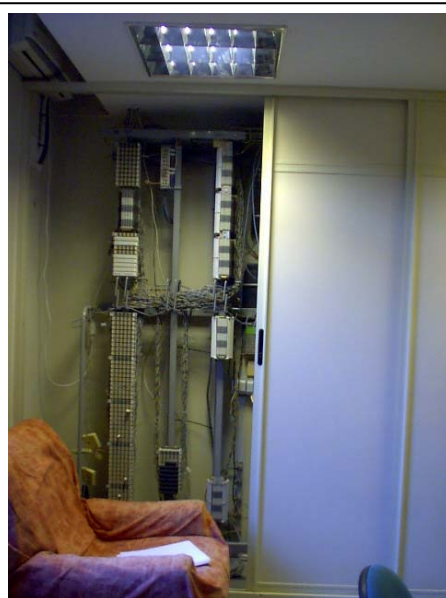
Central Telefónica Detalle Terminales
