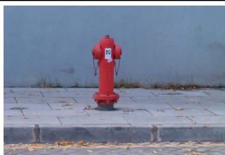
Columna Hidrante al exterior
